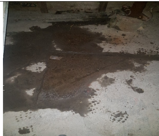
Fotografía 3. Estancamiento de agua alrededor de la boca del pozo.
