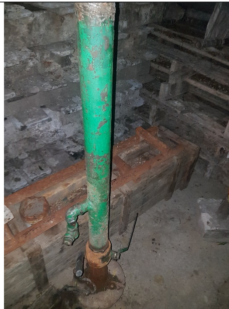
Fotografía 7. Derivación donde se presume la explotación
