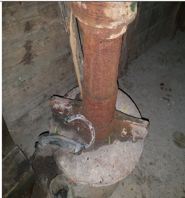
Fotografía 6. Fragmento del tubo de producción donde se observó humedad
